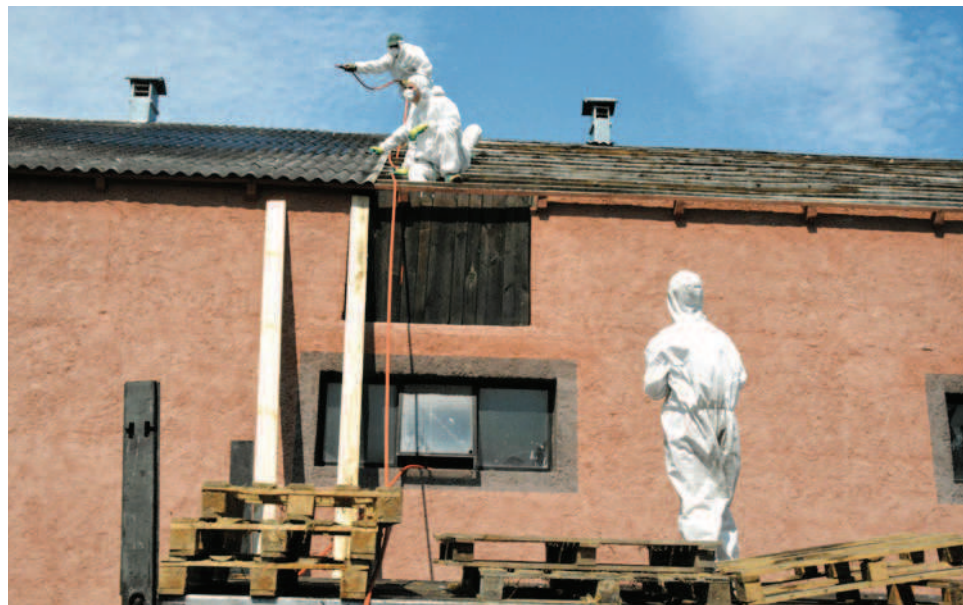
W gminie Wielbark azbest usunięto z dachów budynków 24 gospodarstw Fot. Grzegorz Siemieniuk
